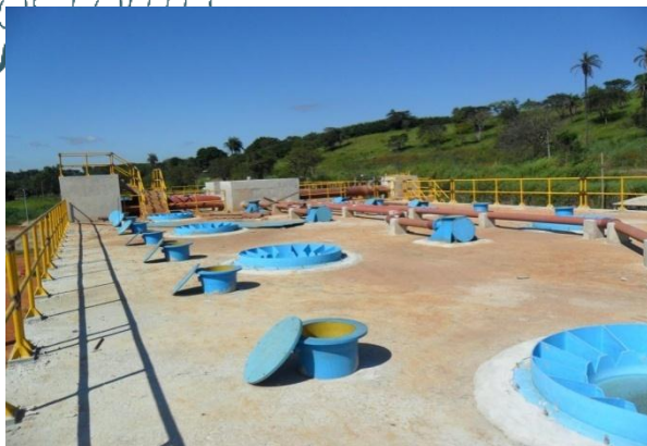
ESGOTAMENTO SANITÁRIO NA RM DE BELO HORIZONTE/MG Reatores da ETE em Pedro Leopoldo
